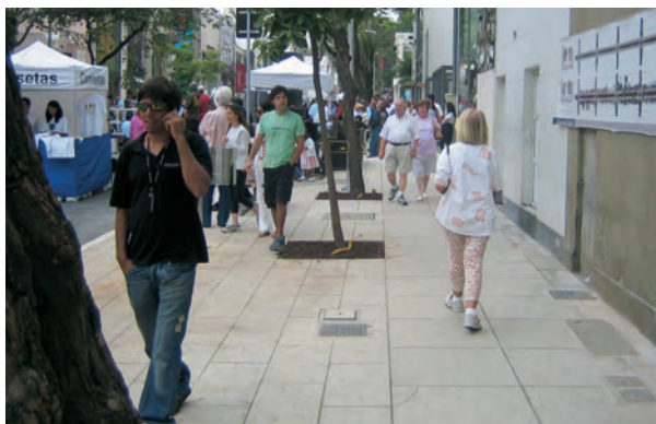
Rua Oscar Freire – Placas de concreto
